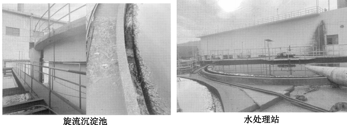
图 5 废水治理措施
