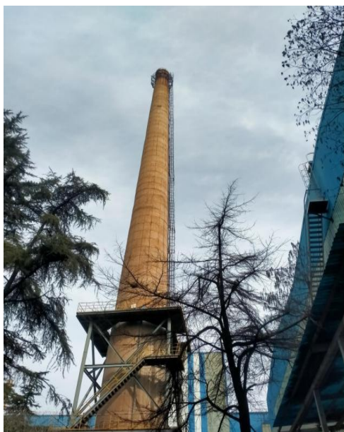
加热炉排气筒
